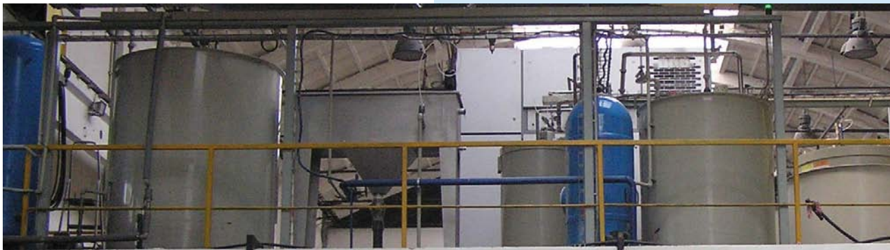
Čistička odpadních vod
