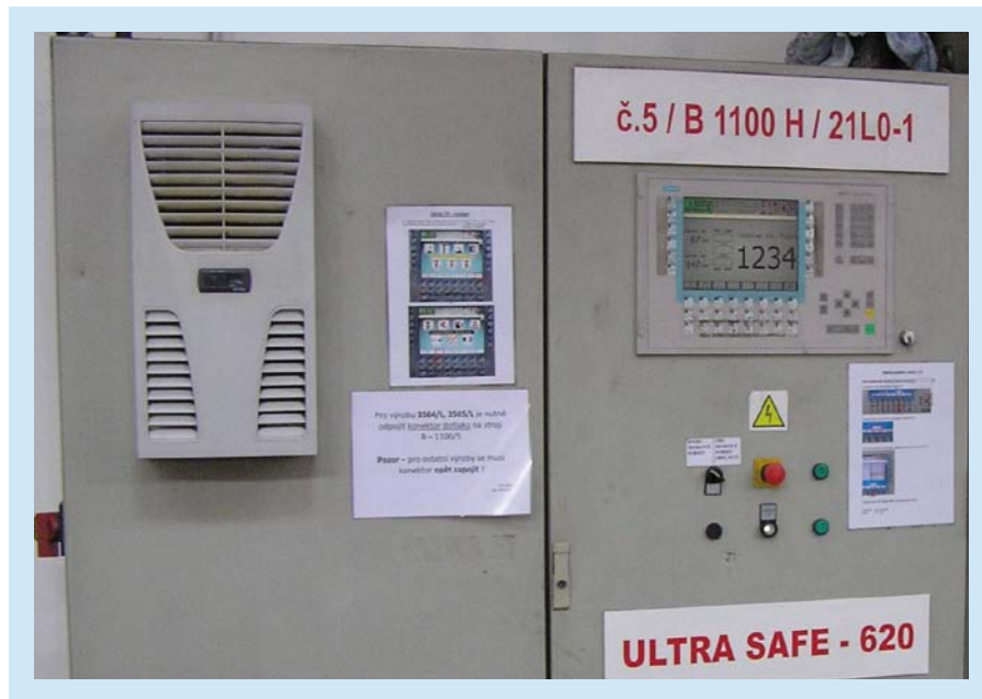
Rozvaděč a řízení pro stroj Bühler H1100B od firmy DCS
