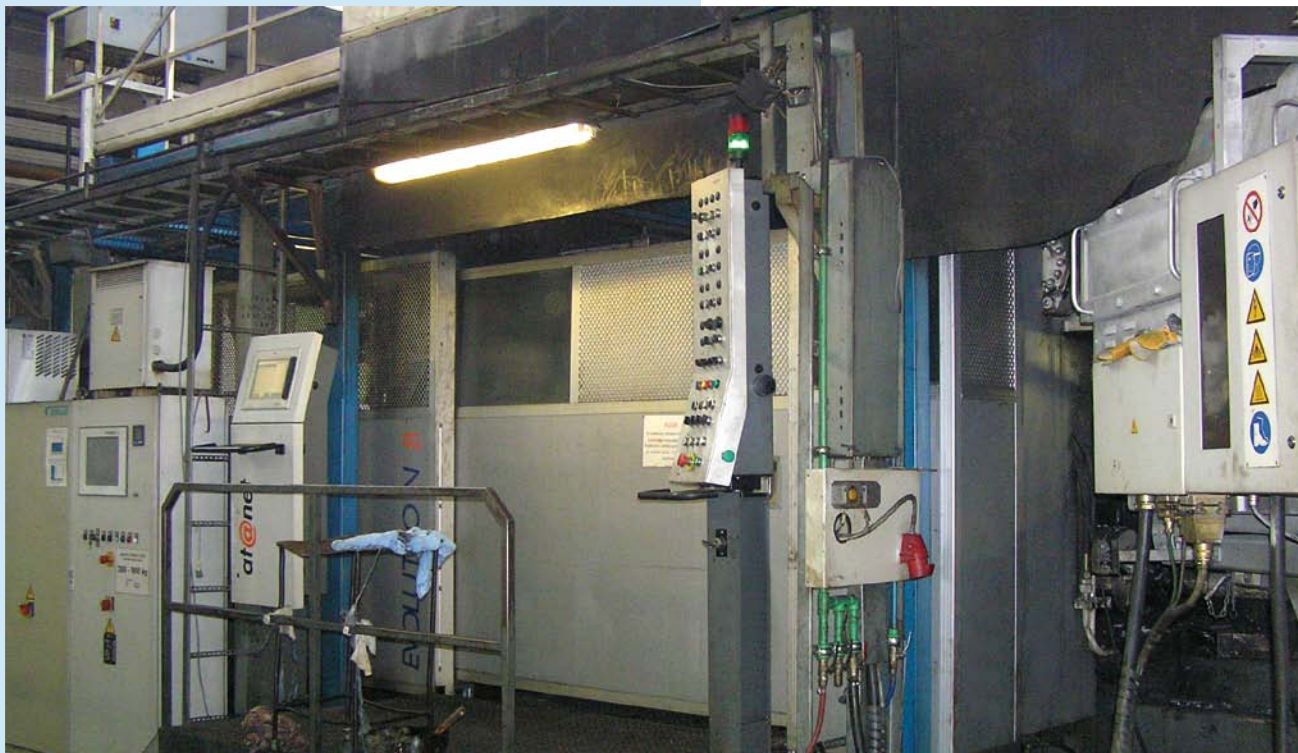
Licí pracoviště s licím strojem Bühler B105D
