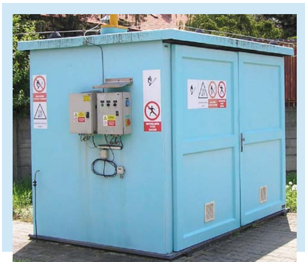
Nová regulační stanice plynu z roku 2001
